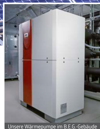
Unsere Wärmepumpe im B.E.G.-Gebäude
